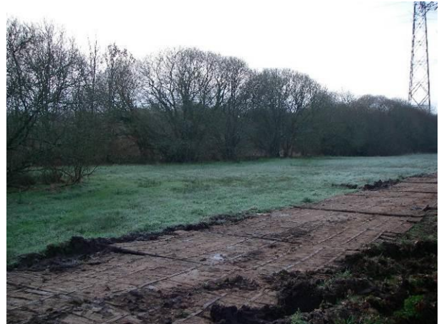
Exemple d'un cheminement provisoire en bois qui protège le sol de la parcelle (bassin du Rion, chantier ERDF)
